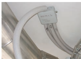
připojení topných kabelů
