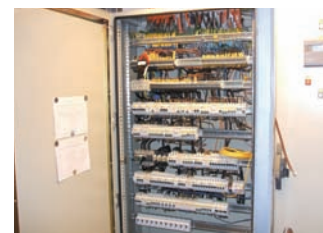
připojení kabelů a termostatů v rozvaděči
