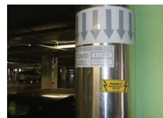
vyhřívané potrubí kanalizace
