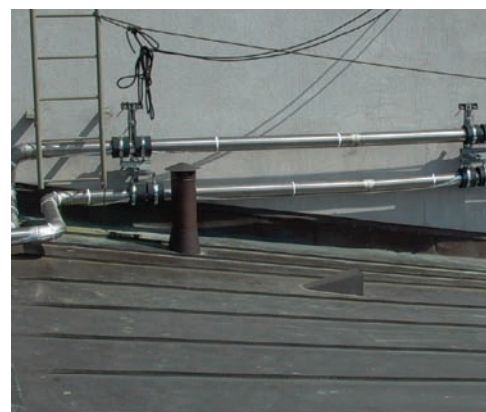
potrubí chráněné topnými kabely
