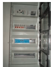
termostat ETO-1550 v rozvaděči
