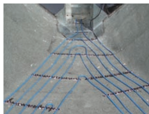
topné kabely v úžlabí
