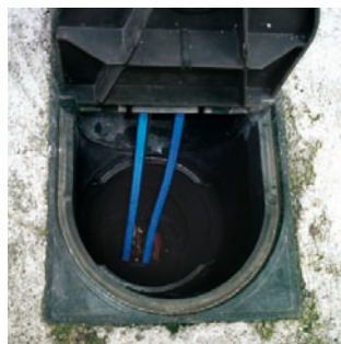
topné kabely ve vpusti
