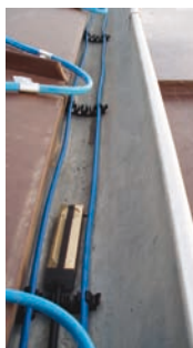
kabely a čidlo ve žlabu
