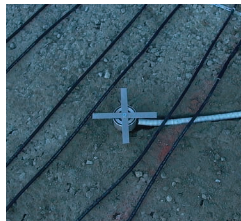
instalace čidla ETOG
